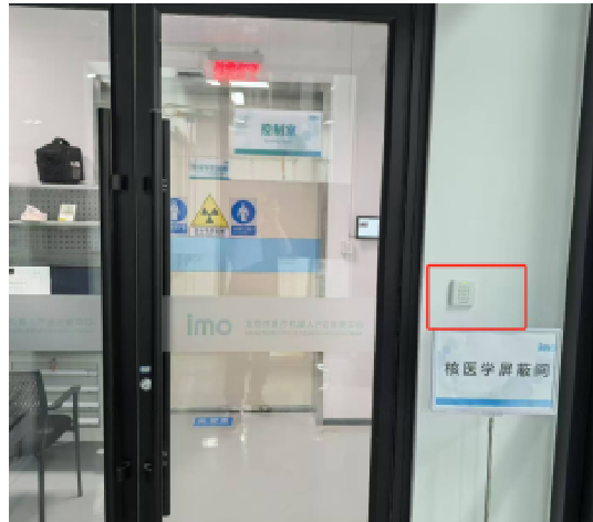
控制室出口门门禁
