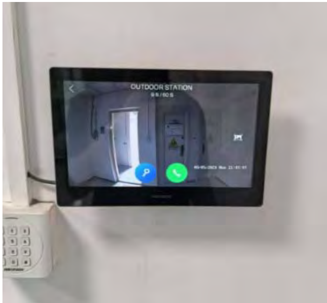
控制室对讲系统
